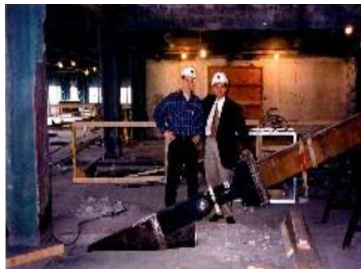
Fig. 6 Amortizori fluidici pasivi instalați la o clădire de birouri din Boston
