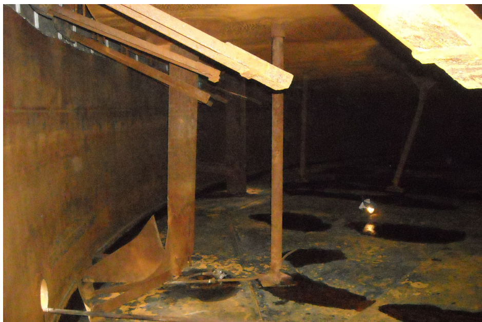
Fig. 3 – Placa de fund a dispozitivului antirotativ deteriorată
