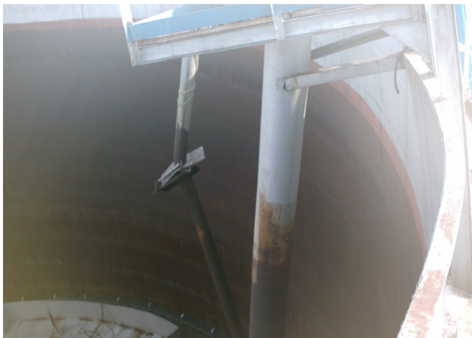
Fig. 5 – Manta deformată în zona dispozitivului antirotativ
