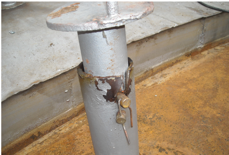
Fig. 4b – Picior deteriorat la exterior
