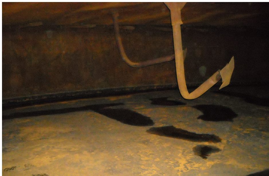
Fig. 4a – Picior deteriorat la interior
